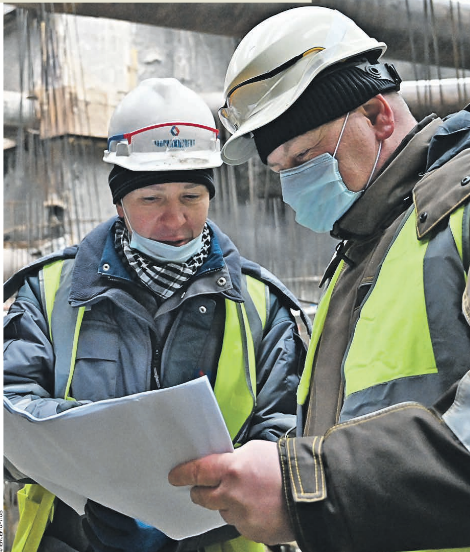
4 января 2021 года. Строители Илья Здобнов и Евгений Вострокнутов сверяются с документацией на площадке строительства станции метро «Кленовый бульвар»
