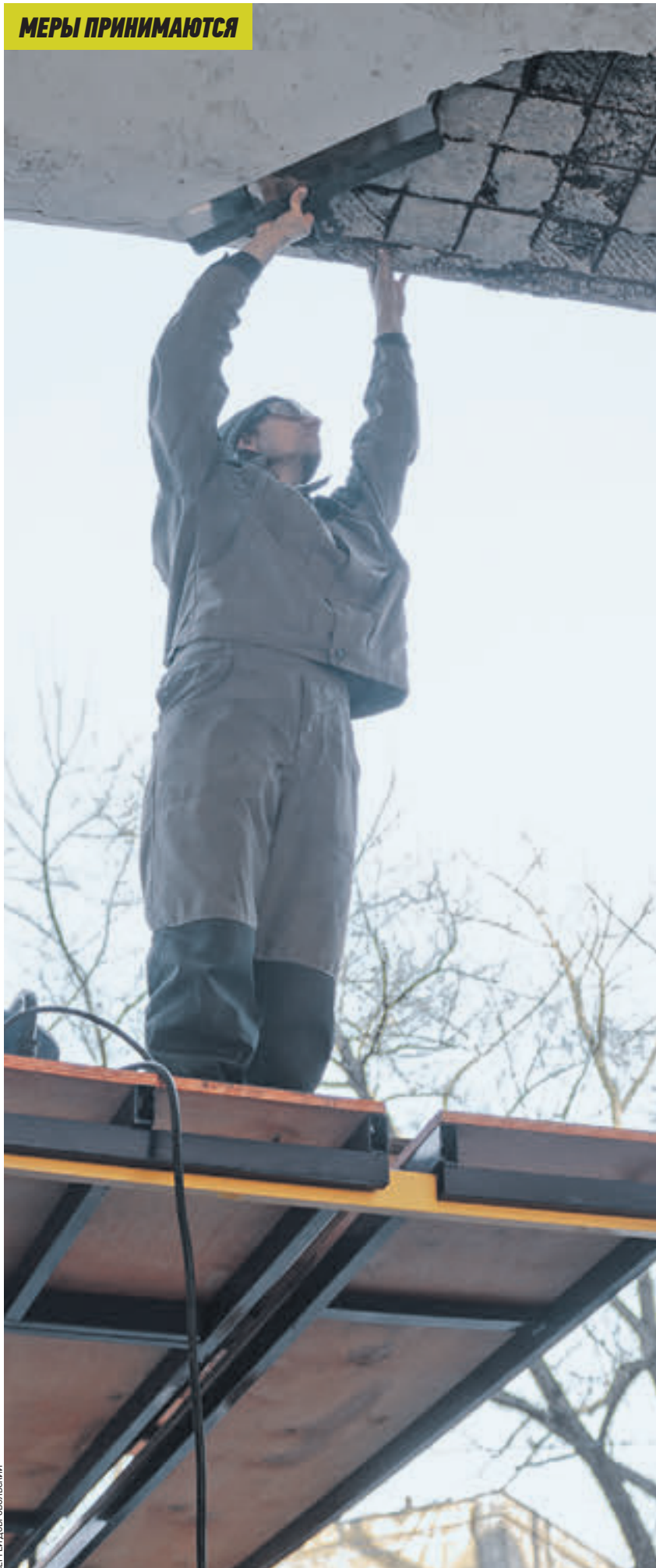
5 апреля 2018 года. Рабочий Леонид Ерофеев зачищает аварийную штукатурку перед началом восстановительных работ в арке жилого дома
