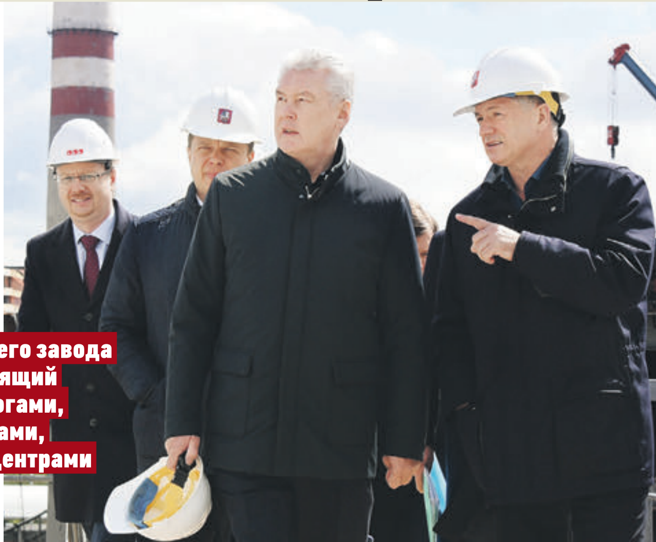
10 мая 2017 года. Управляющий директор компании-застройщика Иван Романов, заммэра Максим Ликсутов, мэр Москвы Сергей Собянин и заммэра Марат Хуснуллин (слева направо) осмотрели ход работ на территории бывшей промзоны Завода имени Лихачева
