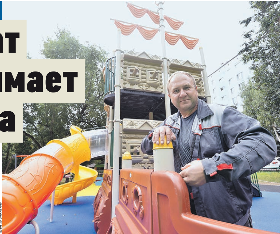
24 августа 2020 года. Сотрудник компании-подрядчика Олег Чернов устанавливает элементы игрового комплекса на детской площадке, расположенной на аллее от Ясеновой, 10, до Каширского шоссе, 142
